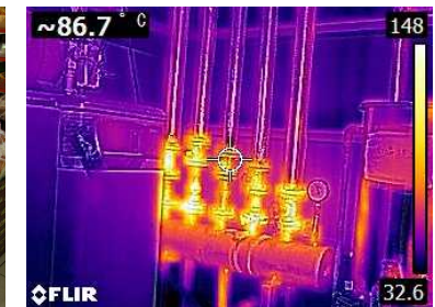
(例) ボイラーヘッダー
