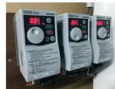
〈インバータ制御装置〉
