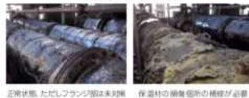
正常状態、ただしフランジ部は未対策 保温材の損傷箇所の様子が写る
